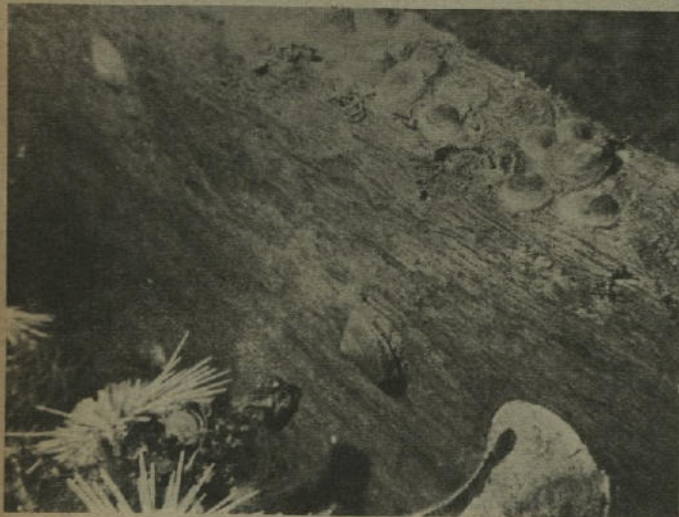
Estado en que se encuentra la madera.
